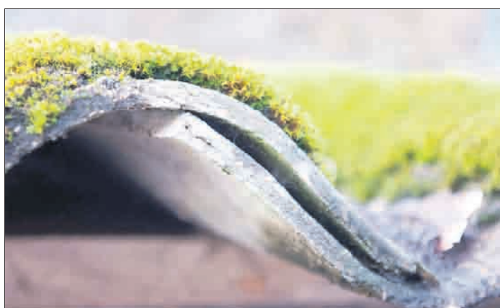
Warten, bis Gras drüber wächst? Auch in unserer Gegend findet man noch Dachwellplatten aus Asbestzement.
